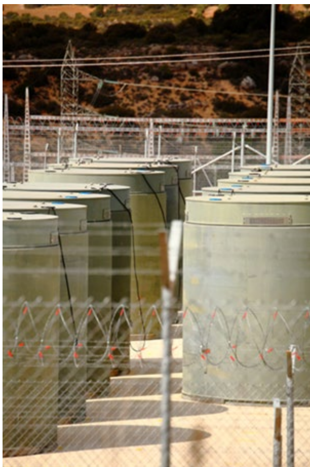
Foto: Almacenamiento de contenedores de combustible
